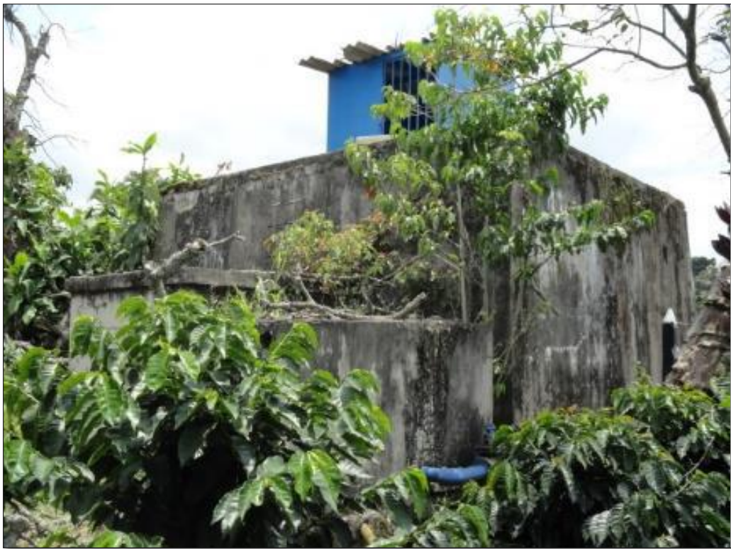
Imagen 12. Tanque de Almacenamiento el Piñal Administración Cooperativa Ulloa E.S.P. Ulloa Valle.
